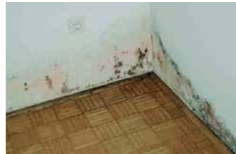
An der Wand sind Feuchtigkeit und gesundheitsschädlicher Schimmel zu erkennen.
