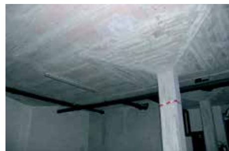
Daraus resultieren ein erheblicher Wärmeverlust und ein Wohnunbehagen. In den beheizten Räumen über dem kalten Keller sind Kondensat und Schimmel zu erkennen.
