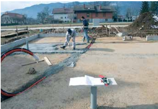
Das vertikale Anbringen der Installationen, Festigung und Nivellieren des Geländes auf welchem später die erste Dämmschicht FIBRANxps verlegt wird.
